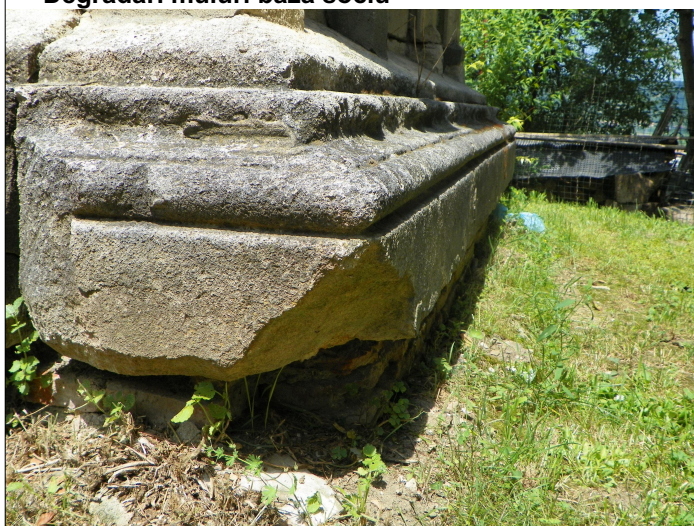
Degradari muluri baza soclu
