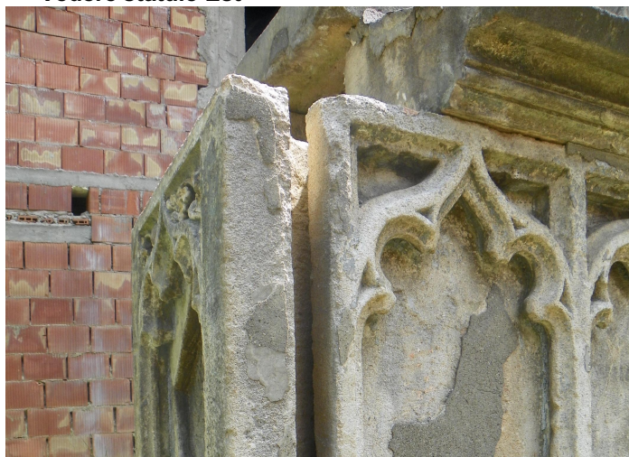
Dislocarea pilcilor soclului in coltul de Nord- Vest in urma unei tentative de furt
