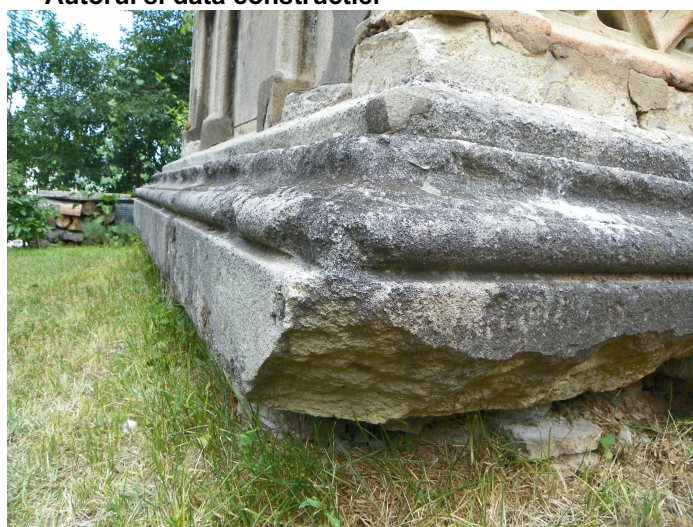
Degradari muluri baza soclu
