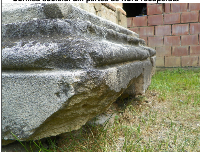
Degradari muluri baza soclu
