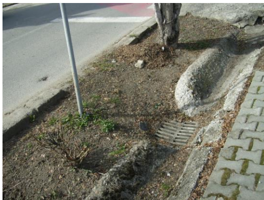
Figura 43 – Gură de scurgere pluvială amplasată eronat (str. Gării)
