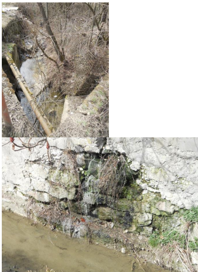
Figura 28 – Albia pâraului Câinelui la podul de la limita de sud Figura 29– Zid de sprijin cu infiltrații de apă uzată
