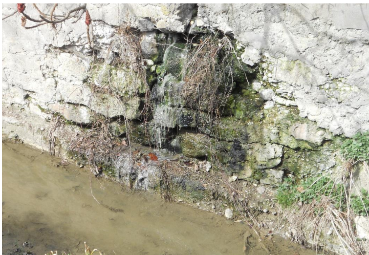
Figura 17 – Zid de sprijin cu infiltrații de apă uzată
