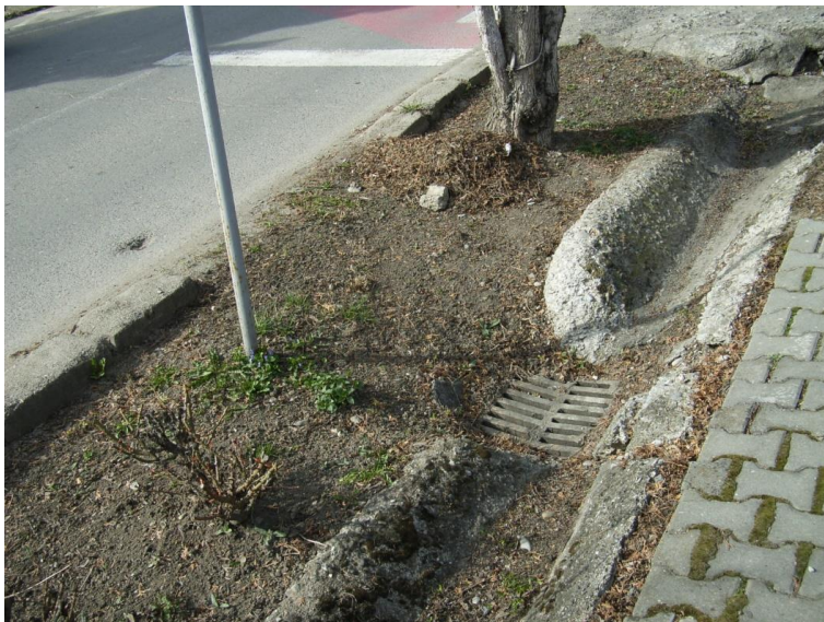
Figura 31 – Gură de scurgere pluvială amplasată eronat (str. Gării)
